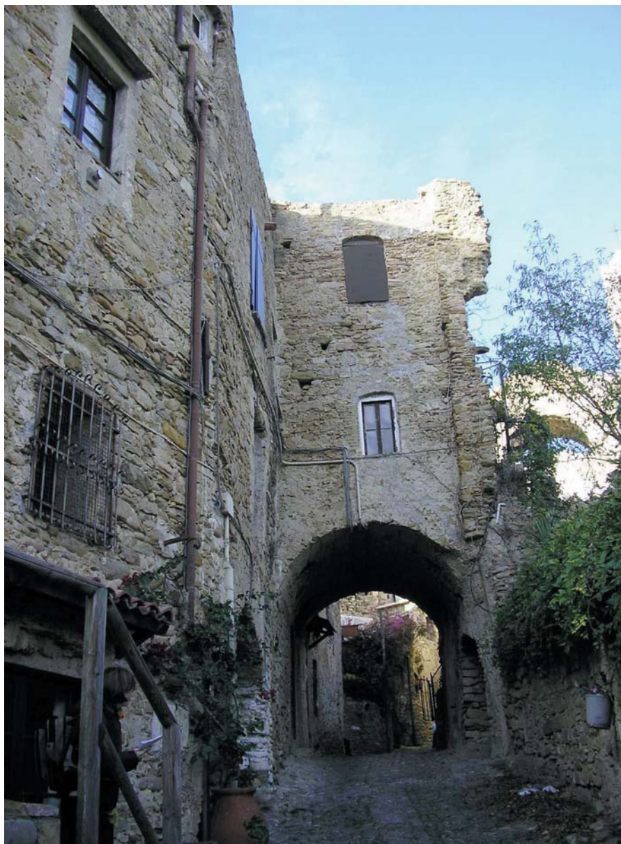
FIG. 7 - Evidenza del grave stato di dissesto di un edificio di Bussana Vecchia. E' possibile osservare come gli interventi di recupero abitativo non riducano certamente la criticità dal punto di vista della sicurezza strutturale.
